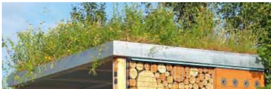
Biodiverse green roof
